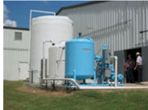
Σύστημα επεξεργασίας λυμάτων σε μεγάλη βιομηχανική μονάδα.
